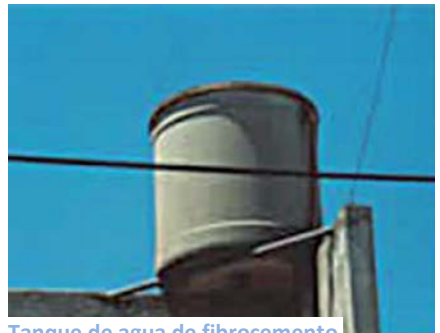
Tanque de agua de fibrocemento
