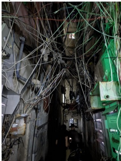
Caótico cableado eléctrico
