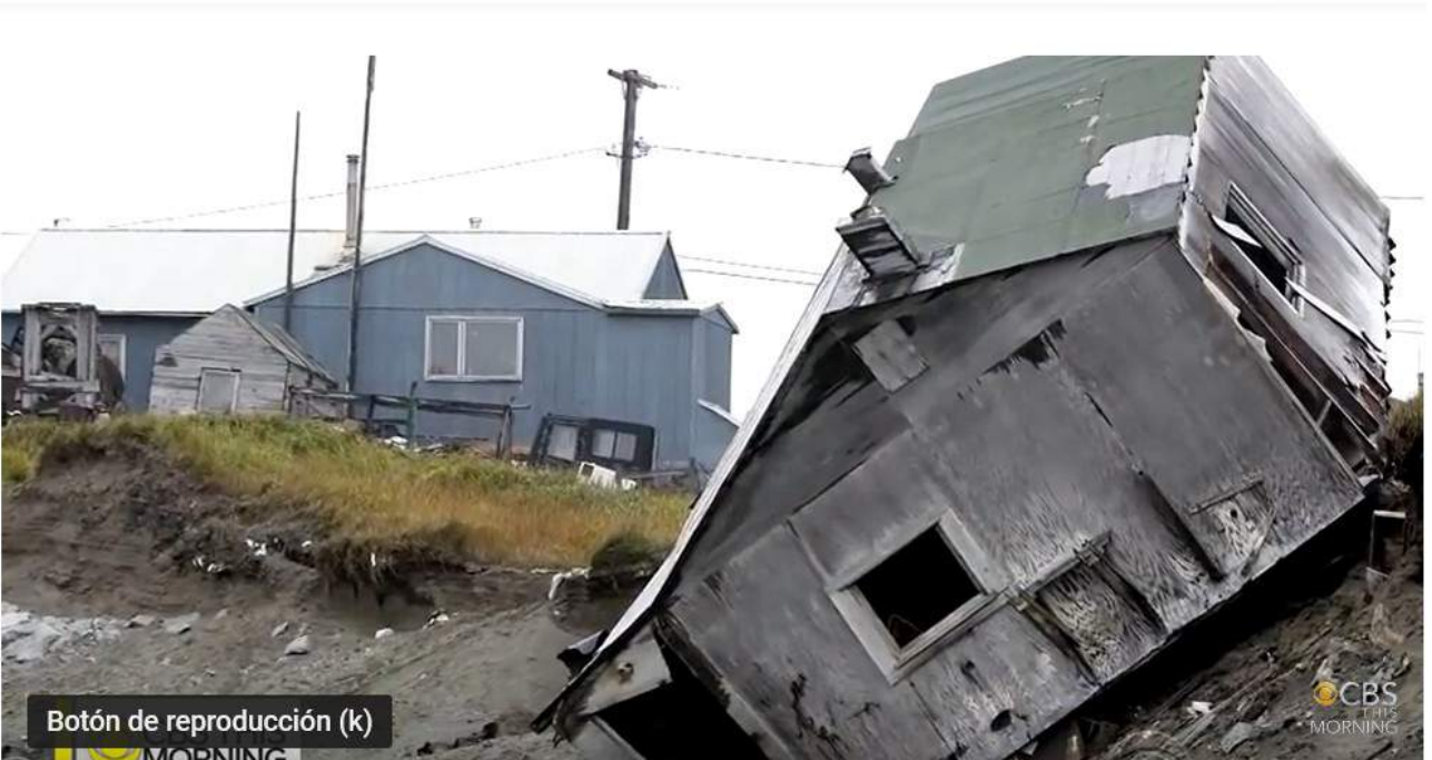
Casas que parecen dispuestas a ser engullidas en un mar de fango
