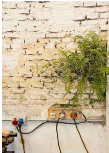
Foto 6: Tablero eléctrico con humedad en el Taller La Nube (inspección ocular)
