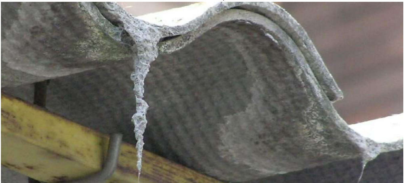
EJEMPLO DE UNA PLACA ONDULADA (CONOCIDA COMUNMENTE CON EL NOMBRE DE URALITA) QUE HA PERDIDO SUS PROPIEDADES CONVIRTIÉNDOSE EN FRIABLE, DESPRENDIENDO FIBRAS DE AMIANTO AL AMBIENTE
