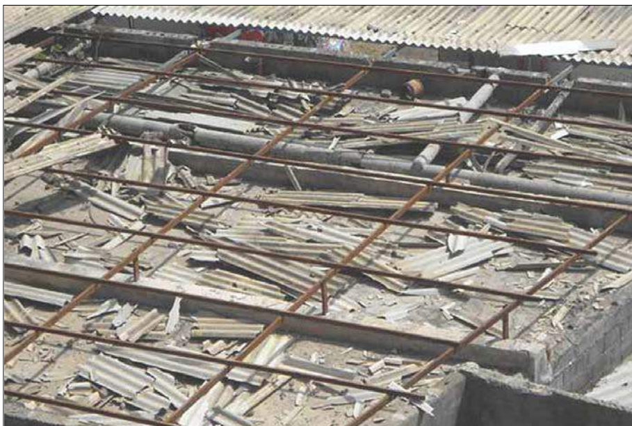
Productos Nicalit destruidos por un ciclón, un seísmo, catástrofes naturales frecuentes en Nicaragua. Algunas décadas después solo subsisten escombros invasores y peligrosos.
